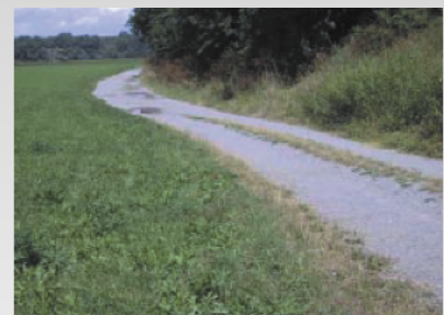
Typische Verschleißerscheinungen an einem gut frequentierten Schotterweg
