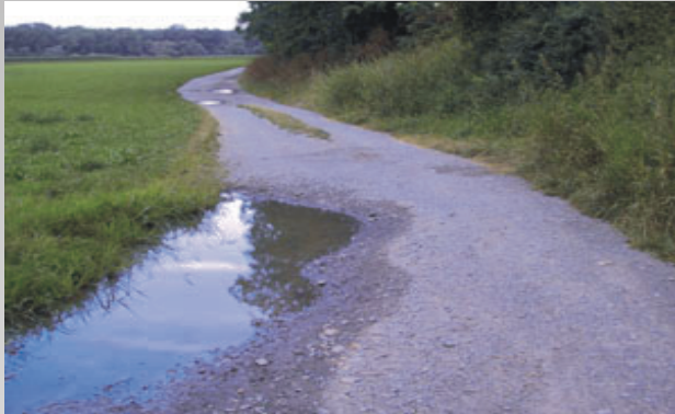
Vorher Wassergebundene Fahrbahndecke mit Beschädigungen
